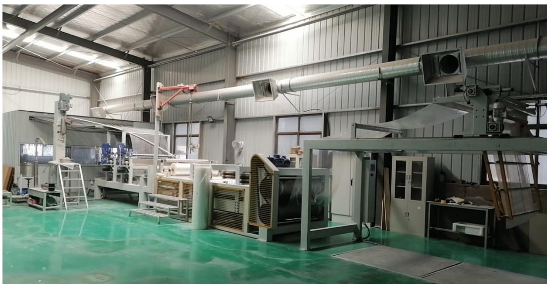
密闭式生产车间；搅拌、覆膜、辊压浸渍工序废气负压收集
